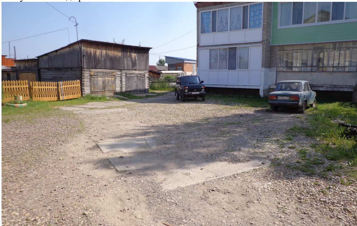
Хомутского 44 до ремонта
